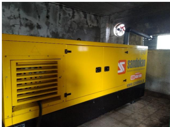
Figura 3.10 – Gerador de emergência da instalação.
