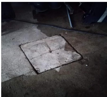
Figura 3.12 – Encaminhamento águas residuais resultantes das lavagens dos pavilhões (chorume) para a caixa recetora.
