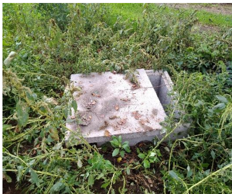
Figura 3.14 – Caixa de receção dos chorumes provenientes dos Pavilhões A e B através das fossas existentes à saída dos respetivos pavilhões.
