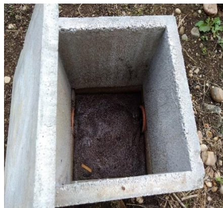
Figura 3.13 – Caixa exterior recetora das águas de lavagens do pavilhão.
